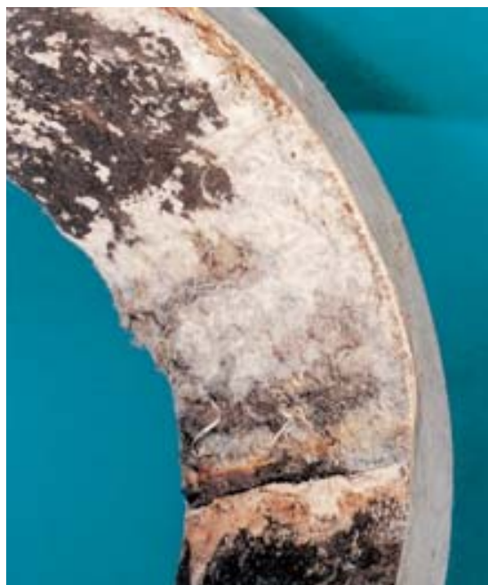
Daños de corrosión en un tubo de presión.
