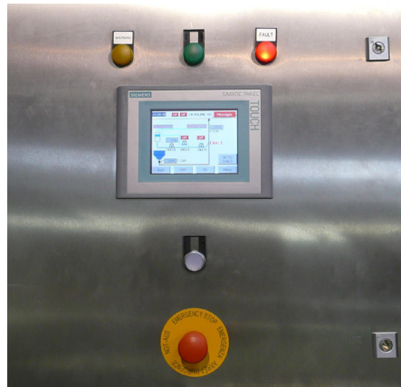
Cuadro de control eléctrico
