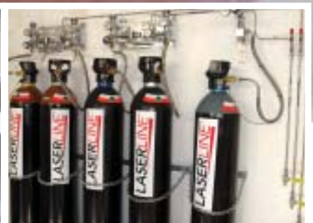
Instalación para el suministro de gases del resonador
