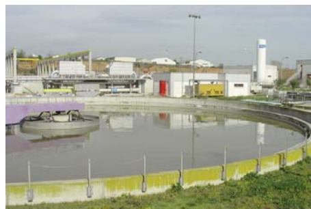
Tratamiento de aguas residuales
